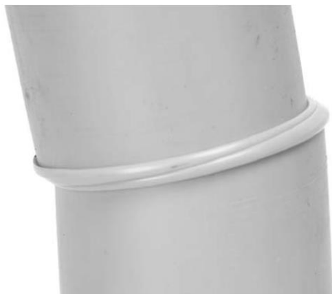
Alineación inadecuada de la tubería "alto-bajo". Articulación visualmente ingleteada.
