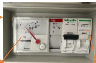
Voltímetro Interruptor de polo a tierra
